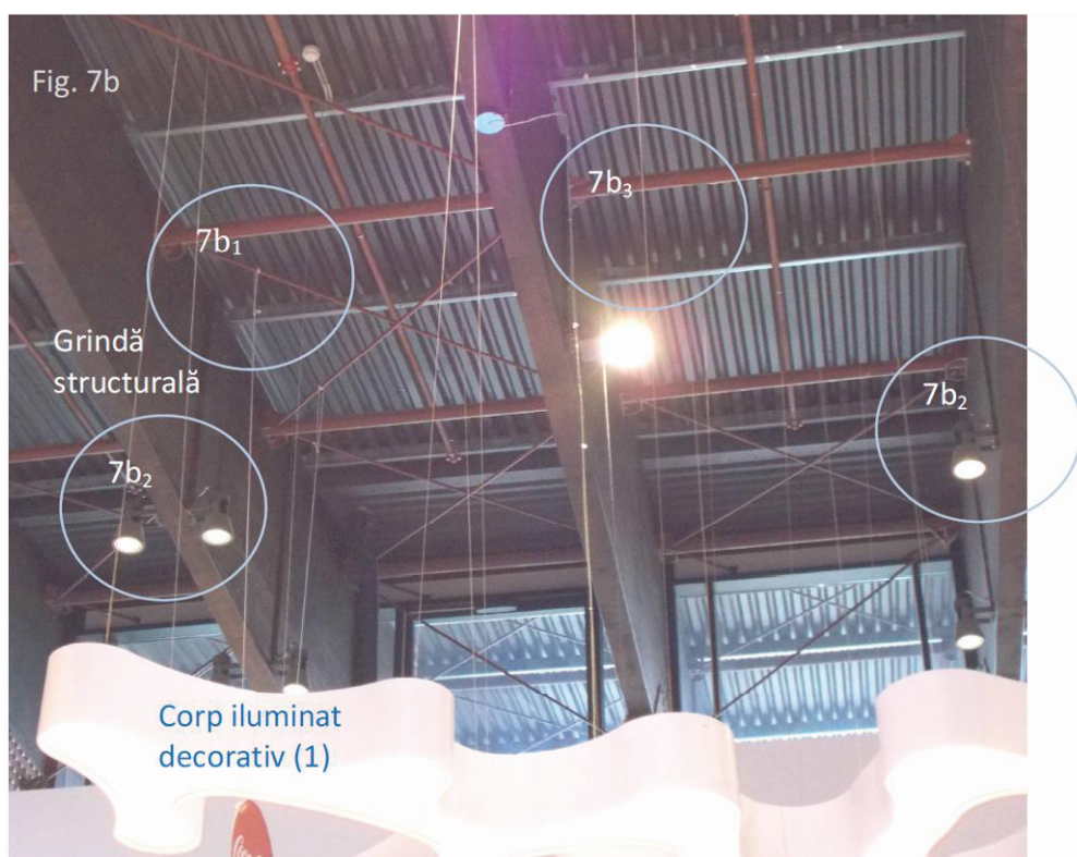
Fig. 7b – Montarea corpurilor decorative de iluminat (1) suspendat, ancorate prin cabluri seismice metalice, fixate la celălalt capăt de bare metalice – grinzi cu zăbrele - montate la plafon (7b 1 ). Bare metalice din profile rectangulare, asigură protecția distribuției circuitului de iluminat (7b 3 ); montarea corpurilor de iluminat de siguranță (7b 2 ) fixate rigid de grinzile structurale.
