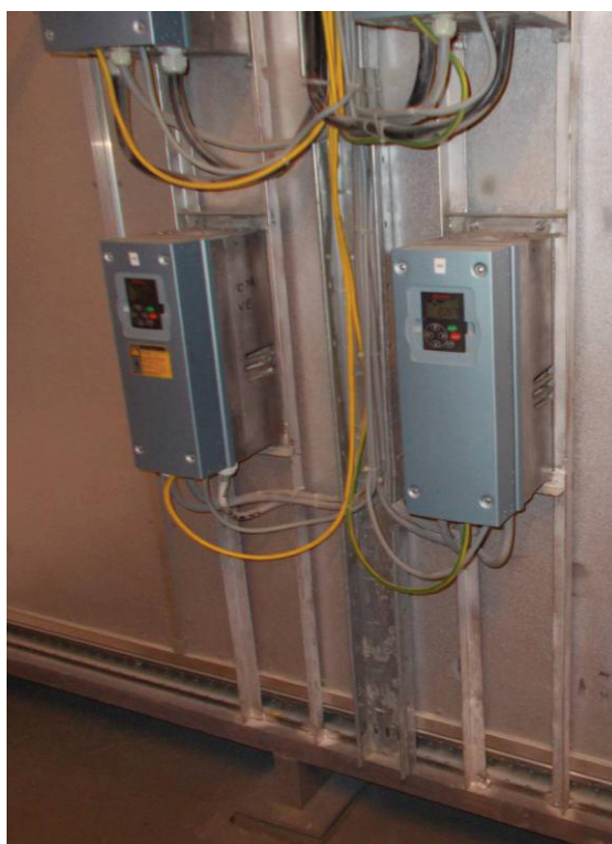
Fig. 2 – Controlere automatizare / panouri de control instalație ventilare/ climatizare clădire birouri – montaj rigid pe un perete aparent suport, pe cadre din profile metalice rectangulare sau U
